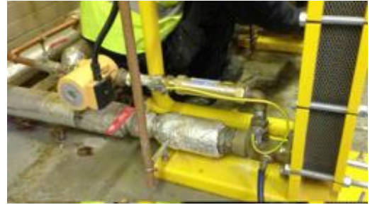
Abbildung 4: JFK Plumbing&Heating Ltd installiert das patentierte AQUABION® Kalk- und Korrosionsschutzsystem
