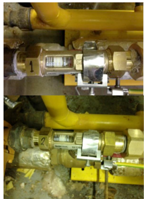
Abbildung 5: 2 Wasserzähler wurden nach jeder Pumpe eingebaut. Die Messung zeigt den Durchfluss VOR und NACH dem Einbau von AQUABION®.
